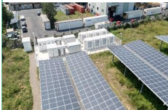
桃园2+4MW/2+4MWh AFC储能案场
