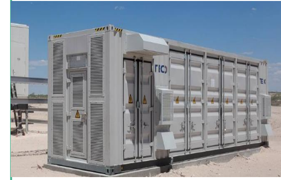
美国2MW/2MWh 储能案场 调频服务
