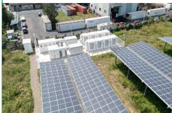
桃園2+4MW/2+4MWh AFC儲能案場
