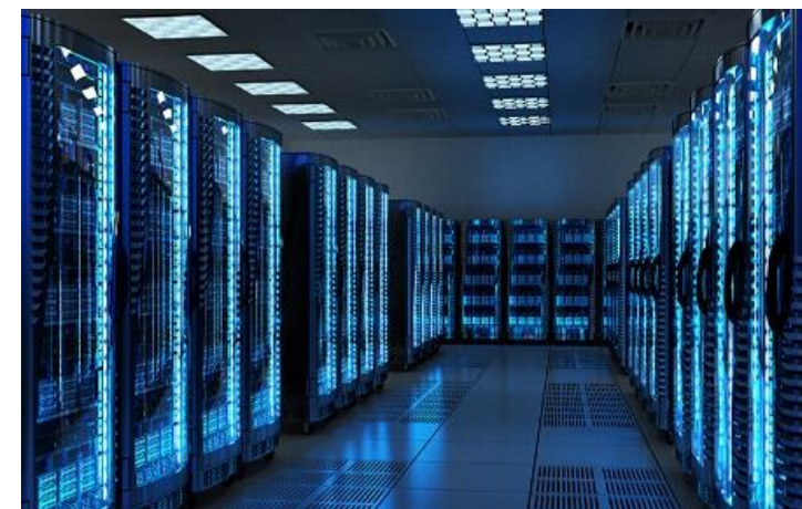
DC 資料中心統包工程
