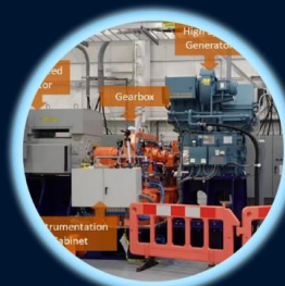
廢熱回收發電系統
